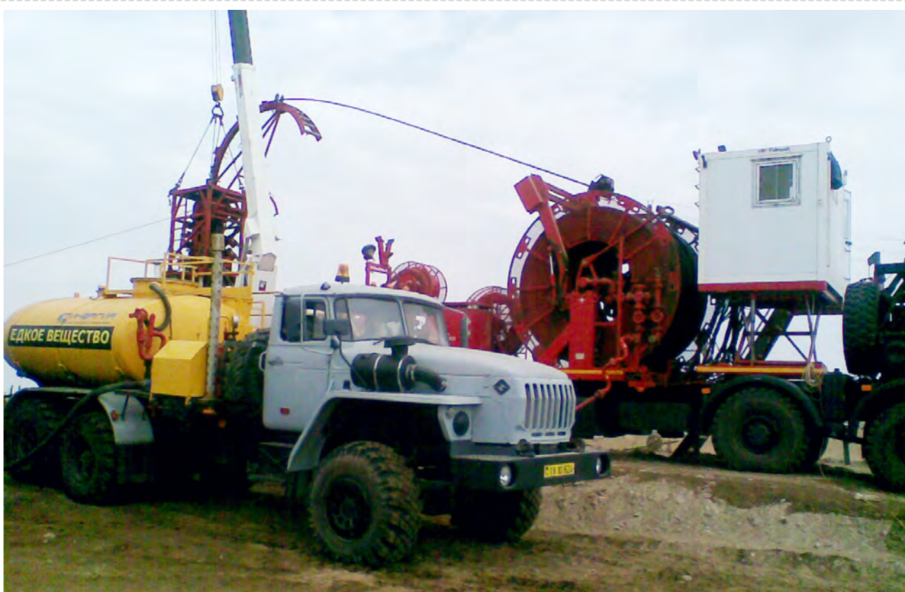
Месторождение Готурдепе: выполнение работ по кислотной обработке пласта с помощью колтюбинговой установки и насосной установки в кислотном исполнении.
